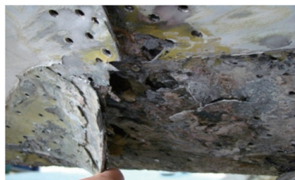
图2 船底蒙皮、龙骨梁及框缘条腐蚀
